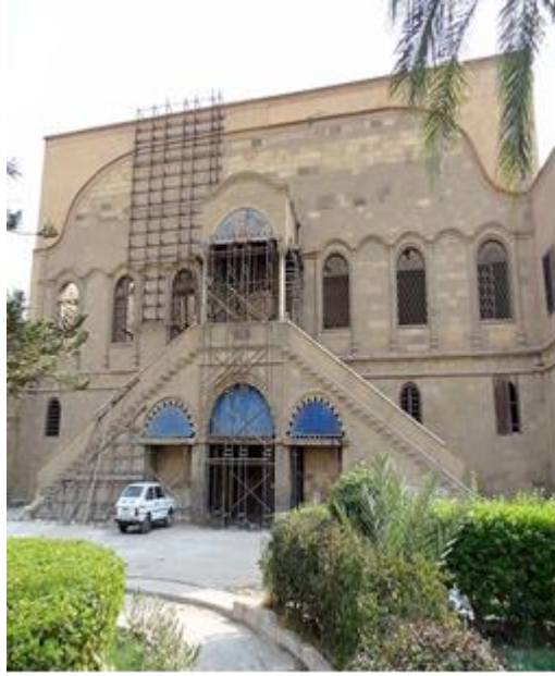
صورة (٢) قصر الجوهرة أثناء مرحلة الترميم وهو أحد القصور الموجودة في قلعة صلاح الدين الأيوبي بجانب جامع محمد علي
